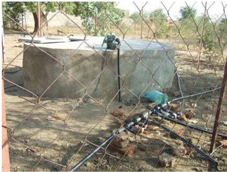
Bassin et système de distribution de l'eau vers le réseau goutte à goutte
